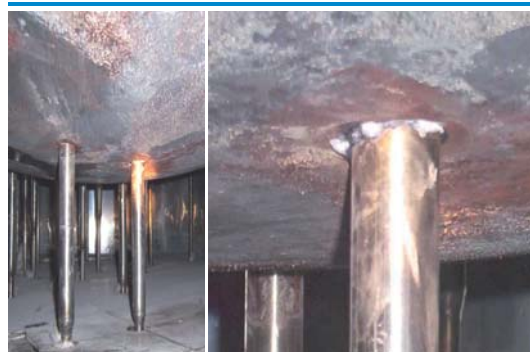
– Nález trhliny na reaktorové nádobě, (Zdroj: www.nrc.gov )
